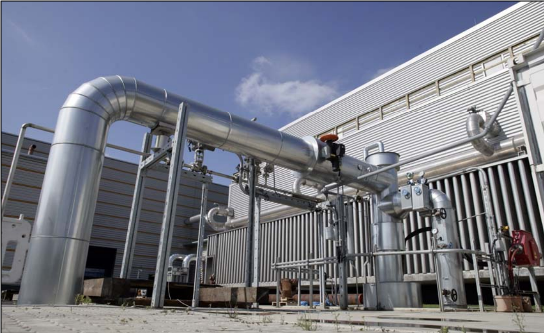
Abb. 2.14: Geothermie-Kraftwerk Unterhaching mit kombinierter Wärme- und Stromerzeugung (Kalina Prozess). /BMU/
